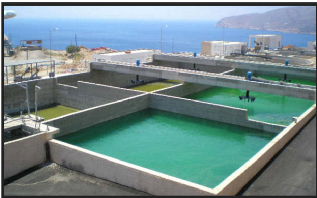
Εικόνα 2-1: Εγκαταστάσεις επεξεργασίας λυμάτων
