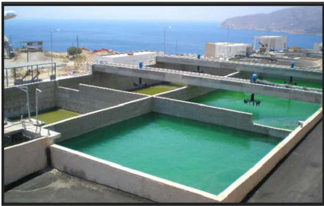
Εικόνα 2-1: Εγκαταστάσεις επεξεργασίας λυμάτων
